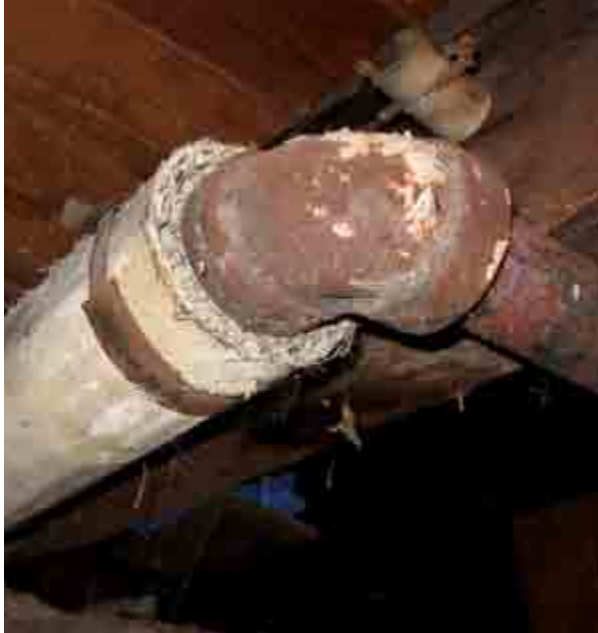
Deterioro de tuberías recubiertas con asbesto en antiguas construcciones.
