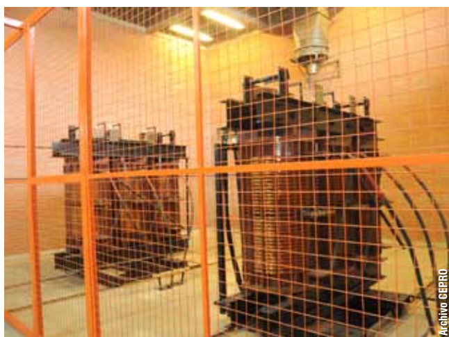
Nuevos transformadores del Pabellón II.
