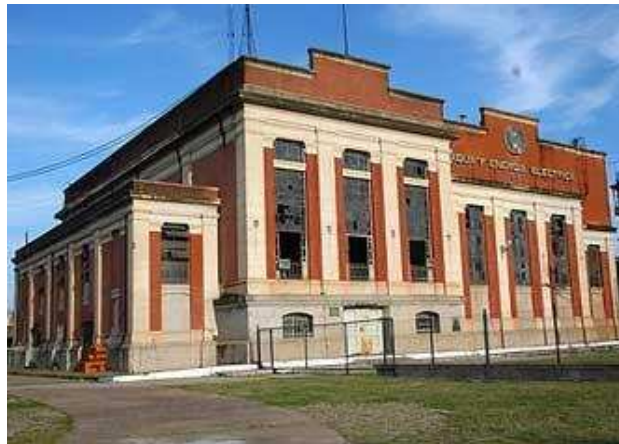
Figura 1.2. Imagen actual de la fachada del edificio de la ex-usina de Corrientes donde puede observarse el estado de abandono.
