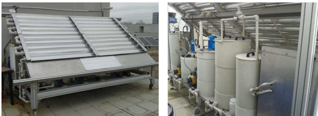
Figura 3.3. Planta piloto solar.
